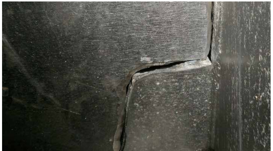
Kuva 7. Prosessilaitteen enneaikainen väsymisvaurio.
