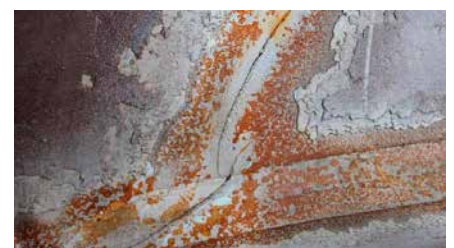
Kuva 8. Offshore-laitteen enneaikainen väsymisvaurio.
